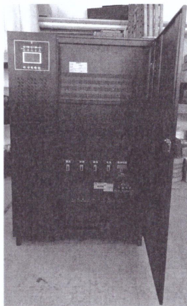
图 2 HP100KS 型在线式通信用交流不间断电源 (UPS) (380V/380V 100kVA 在线式) 设备内部
